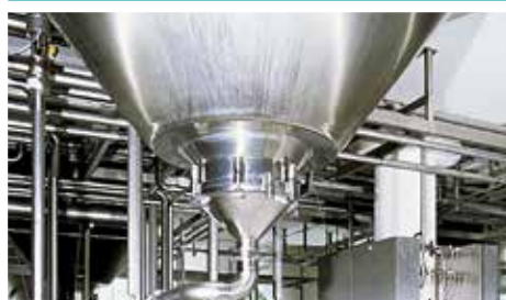
罐体及压力容器
